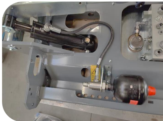
Akkumulator mit Anfahrzylinder verbunden
